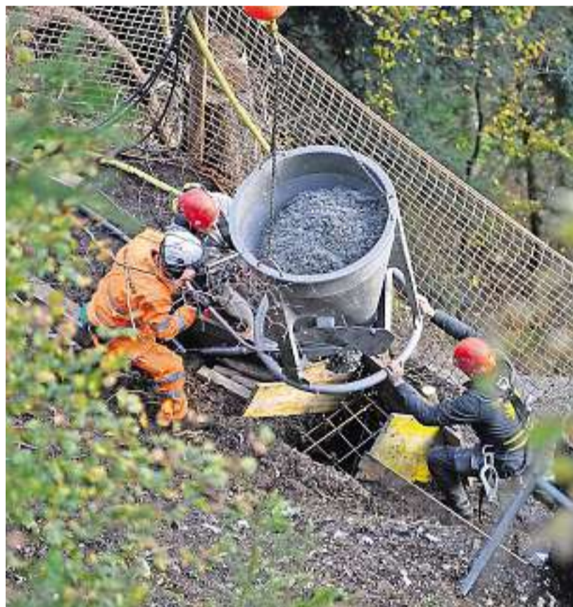
Auf der extrem steilen Baustelle geht nichts ohne Sicherheitsnetze und Schutzbauten. Bild Stoosbahnen AG
